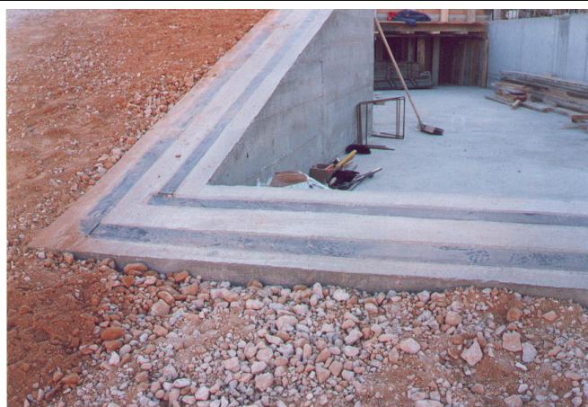
Foto 6.3.. Muro con doble pletina de PEAD para más seguridad.
