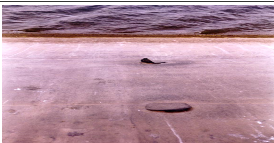
Foto nº. 4.6.. Parches levantados en lámina de EPDM. Torrecilla. Lorca. Murcia.
